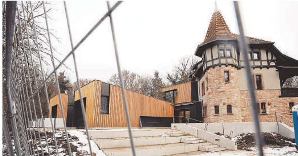
L'ancien auberge et le nouveau bâtiment ont été construits dans le respect des règles de Haute qualité environnementale (HQE). (Photo DNA-Nicolas Pinot)
