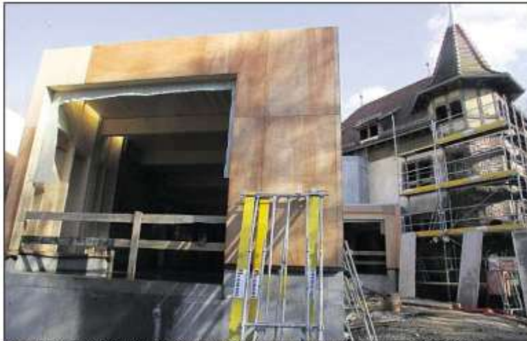
Au premier plan, l'extension comportant les deux salles pédagogiques. Les visiteurs auront une vue surplombant la clairière. Photos Hervé Kielwasser
